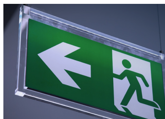
Not- und Sicherheitsbeleuchtung
