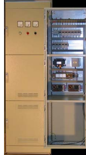
Ausführung mit integrierten Notlichtkreisen, Verteilung und geschottetem Akkuabteil
