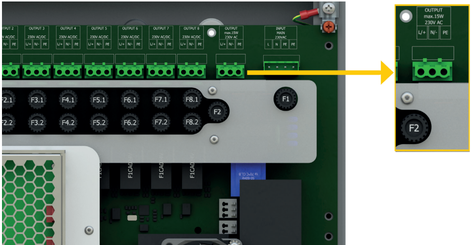
Abb. 20: Anschluss externe AC-Verbraucher
